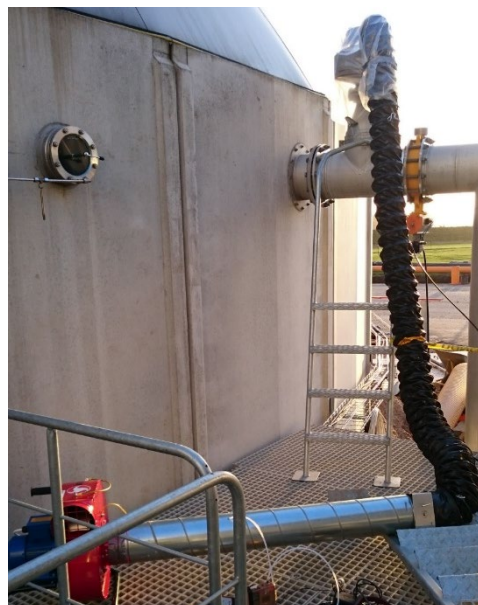
Figur 28. Utspädningsprovtagning av läckande säkerhetsventil.
