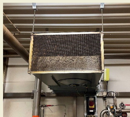
Figur 12 Luftintag till väggmonterad frånluftfläkt.
