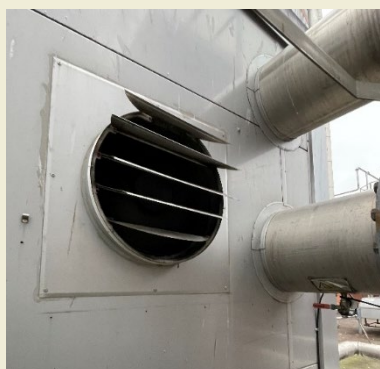
Figur 10 Frånluftventil med jalousispjäll.
