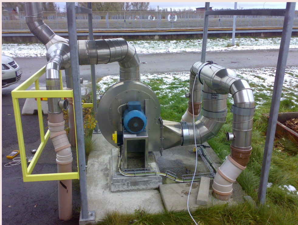
Figur 20. Ventilationsfläkt med 3 st delflöden på sugsidan och 2 st delflöden på trycksidan.
