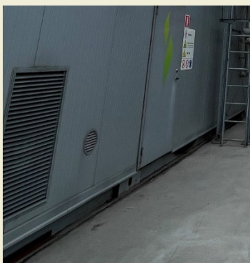
Figur 11 Luftintag till processrum.
