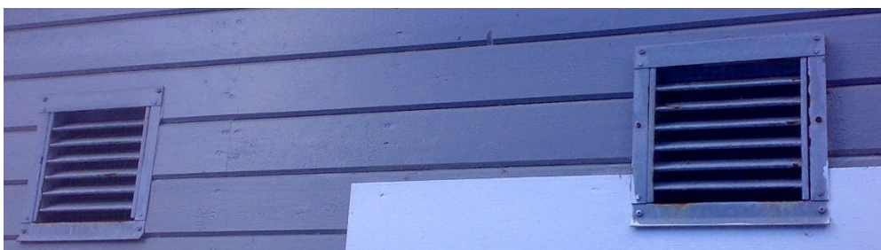
Figur 21. Ventilationsöppningar i gasutrustningshus.
